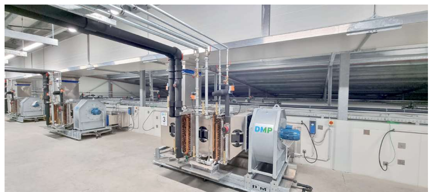
Air handling unit.
